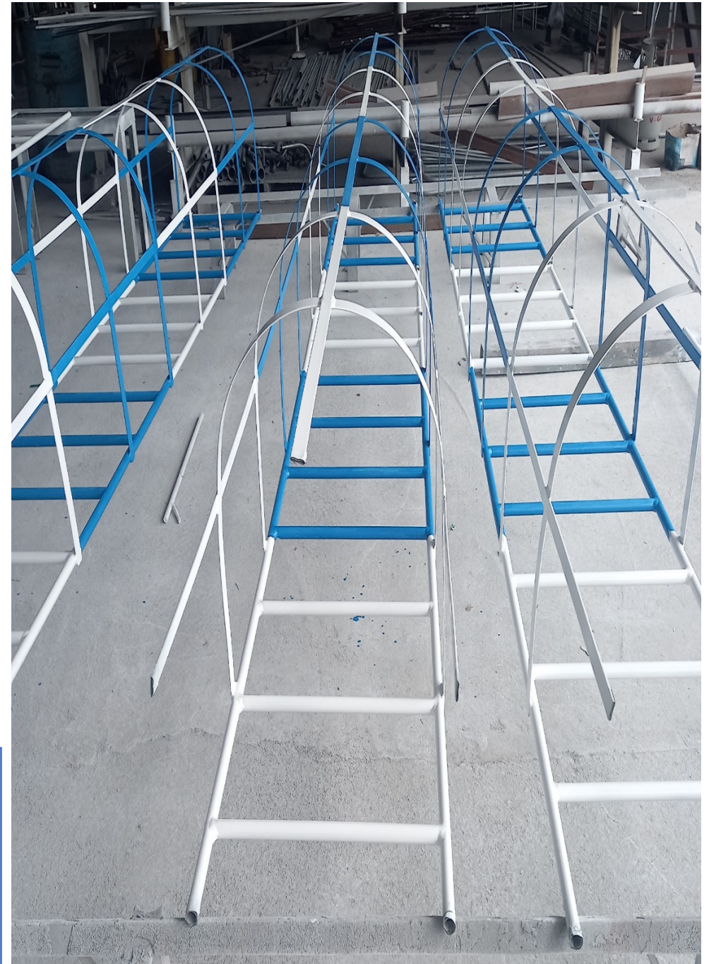
Chế tạo và lắp đặt thang thoát hiểm (Production and installation of emergency ladder) Dự án: Trường Đại học Nha Trang - 2022) (PROJECT: NHA TRANG UNIVERSITY - 2022)
